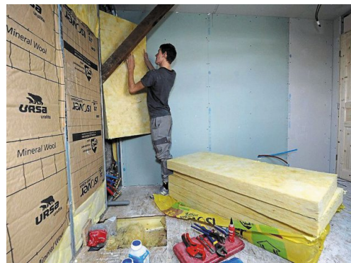
Chez Orne habitat, plus de 1 100 logements sont classés G et F dans la classification énergétique.
